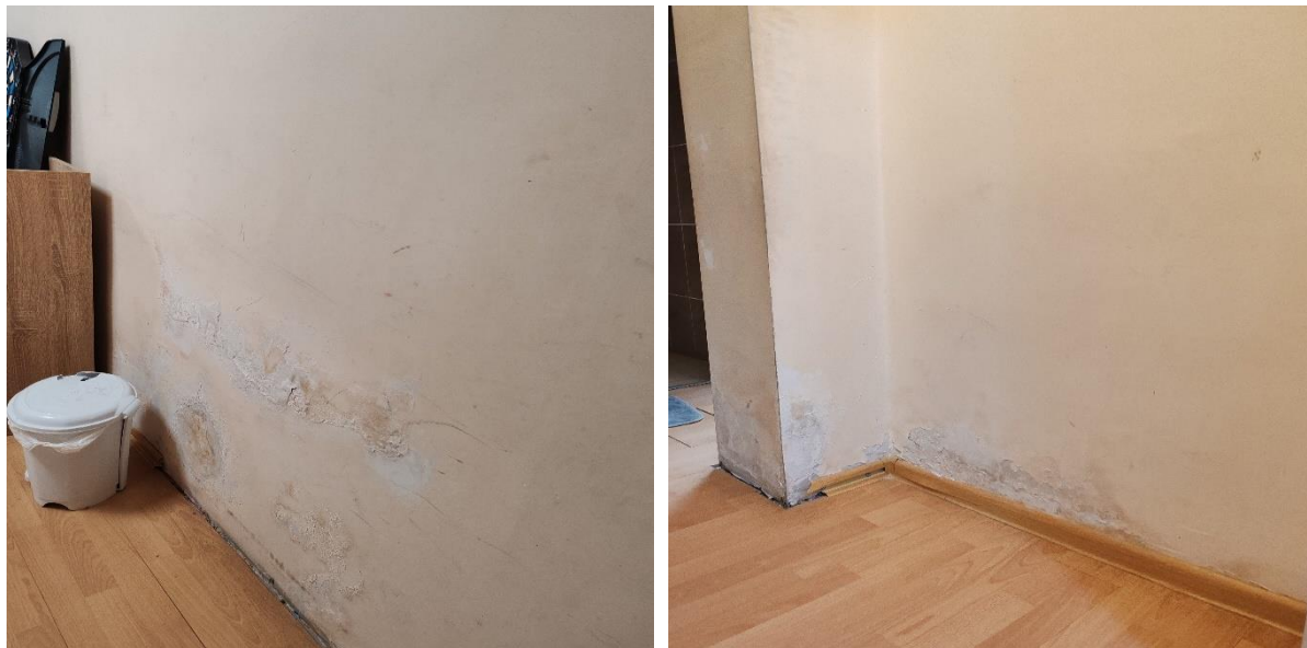
Пукнатини и влага в коридор и спално помещение в ЦНСТДБУ – с. Лесново
